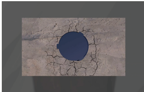
03 콘크리트의 철근이 팽창하여 균열이 발생
